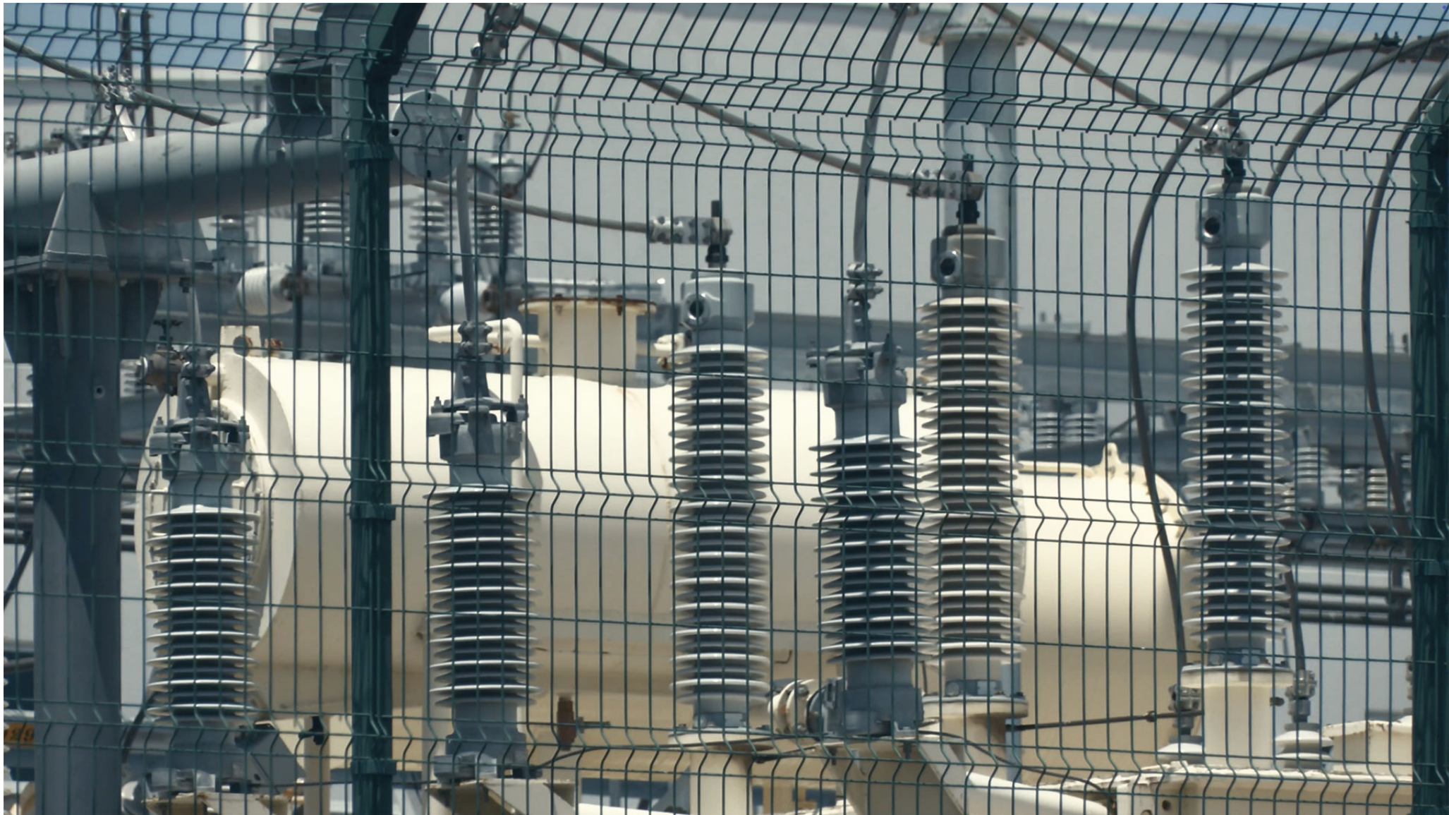
Centros de datos tienen una capacidad máxima de 250 megawatts. Foto: N+
